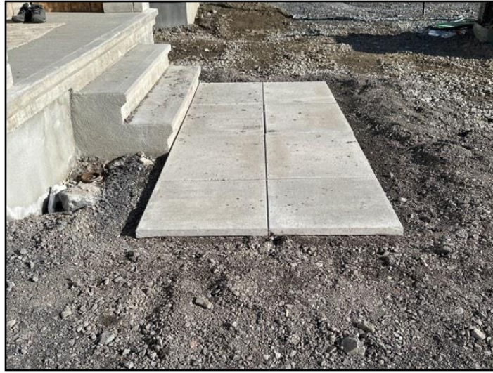
117. Uneven (trip hazard)
