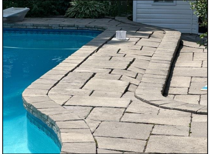
64. Uneven (trip hazard)
