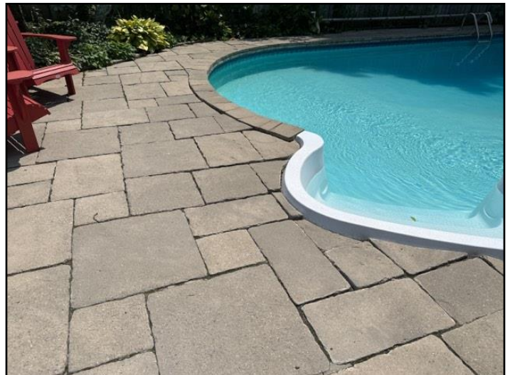
66. Uneven (trip hazard)
