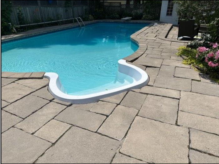
63. Uneven (trip hazard)
