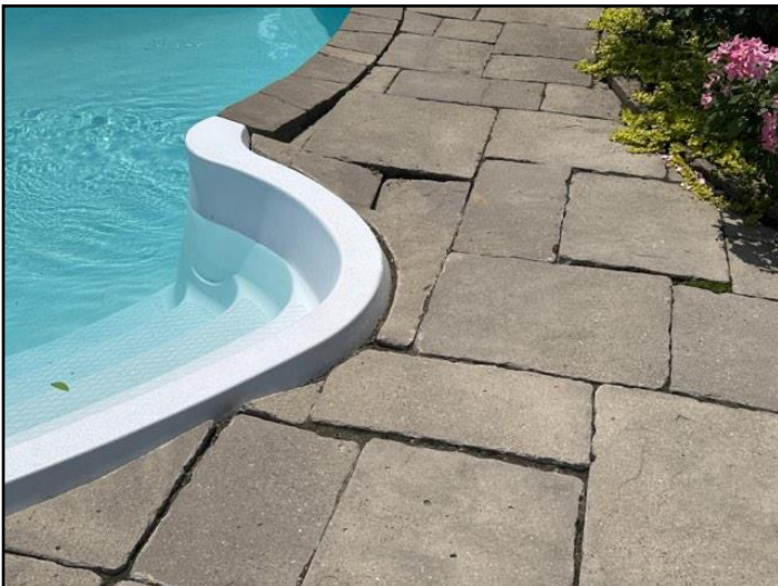
65. Uneven (trip hazard)
