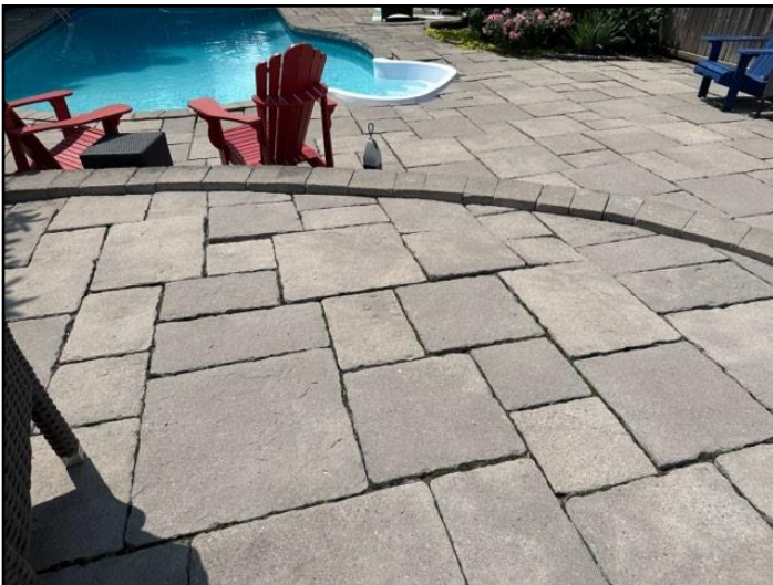
69. Uneven (trip hazard)
