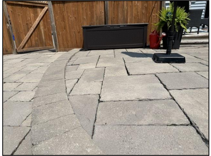
68. Uneven (trip hazard)
