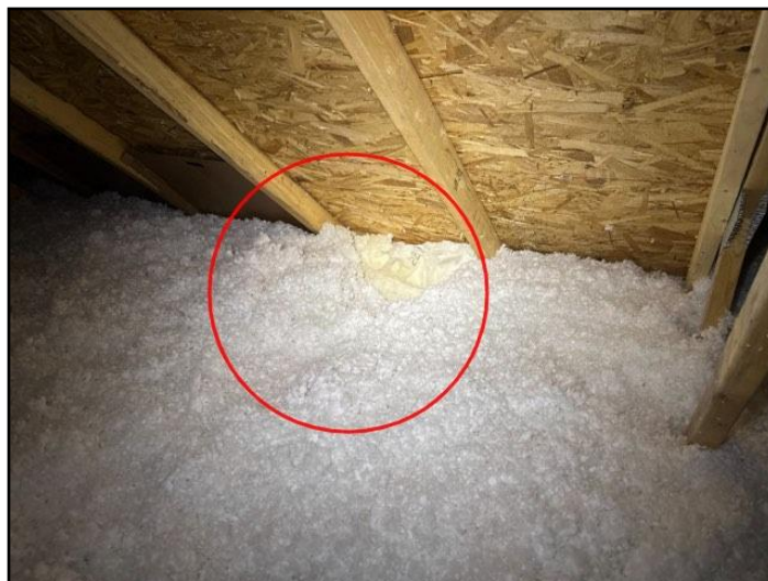
151. Gaps or voids
