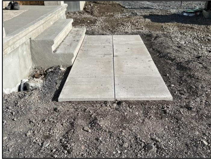
117. Uneven (trip hazard)
