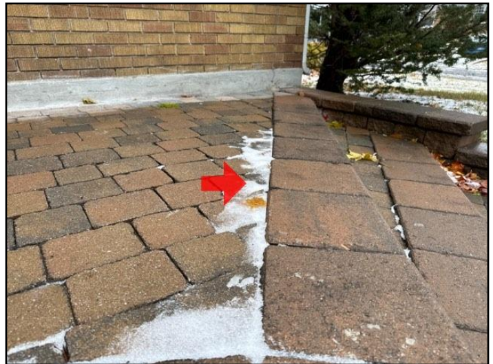
27. Uneven (trip hazard)
