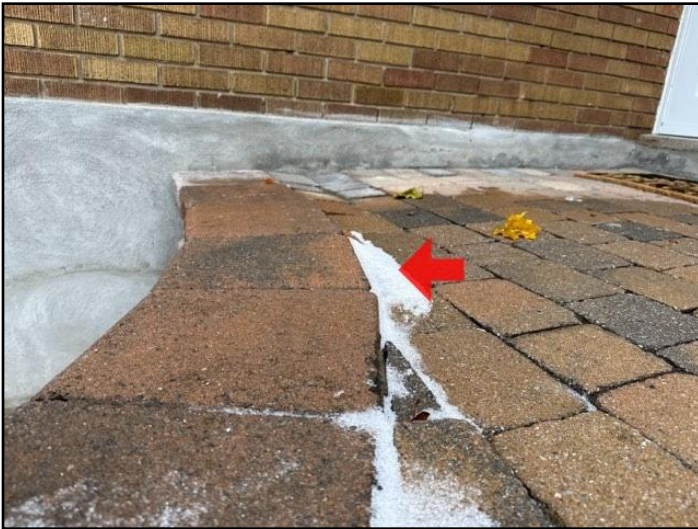
28. Uneven (trip hazard)
