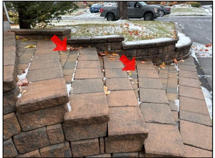
29. Uneven (trip hazard)
