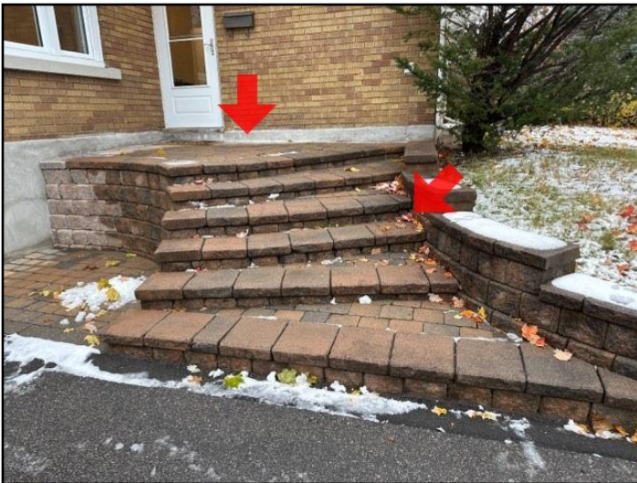
26. Uneven (trip hazard)
