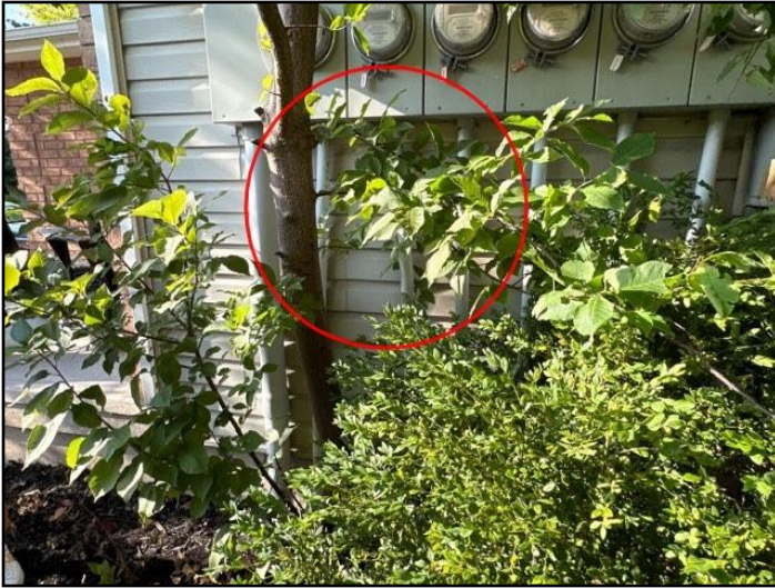
43. Conduit or cable damaged
